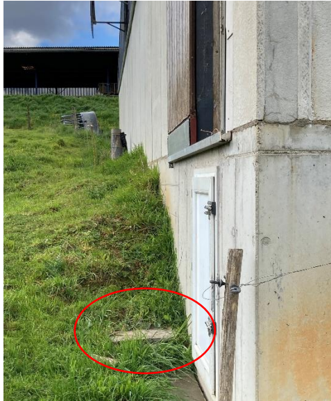
Figure 11 : Regard de contrôle en bout du bâtiment de 2012.
