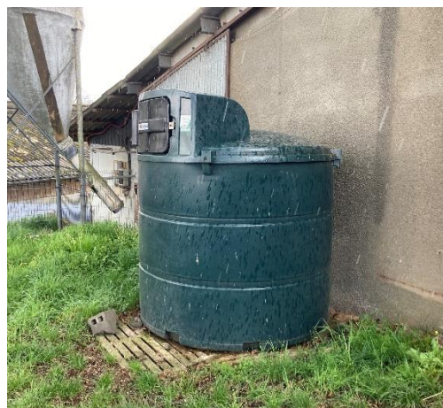
Figure 38 : cuve aérienne double paroi pour le stockage du fuel agricole
