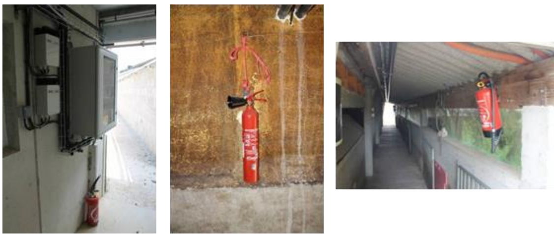
Figure 40 : photos des extincteurs sur site
