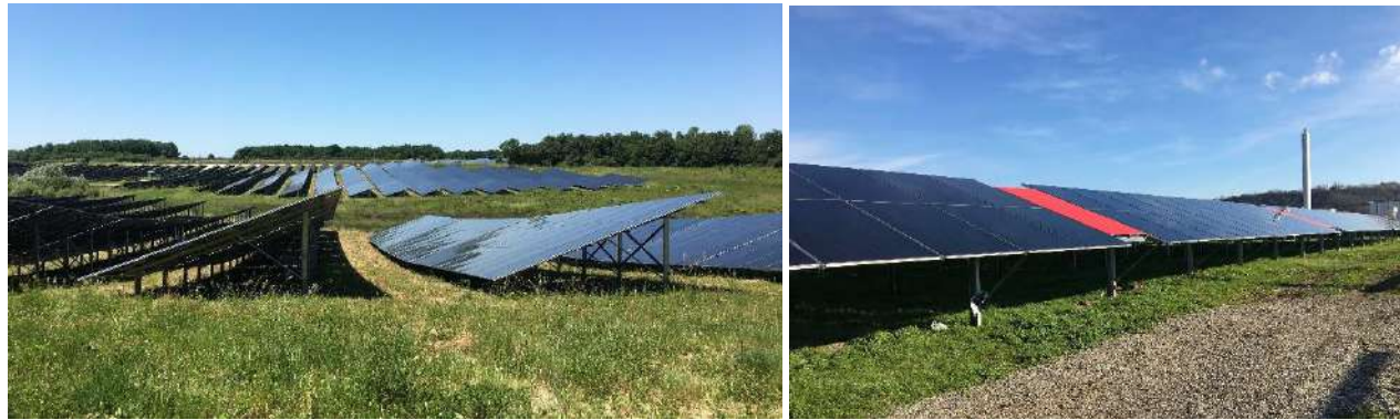
Exemples de réalisations Urbasolar : Nersac (16) et l'Oncopole de Toulouse (31)
