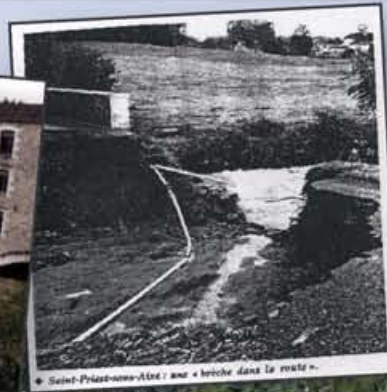
Brèche dans la route de St-Priest-sous-Aixe 23/09/1993
